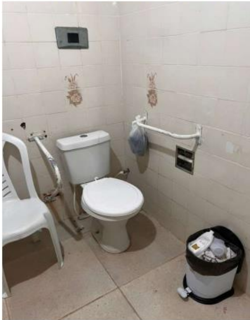
4) Um dos banheiros de um quarto feminino, com bastante sujeira e barra de apoio desgastada. Não havia papel higiênico disponível;
